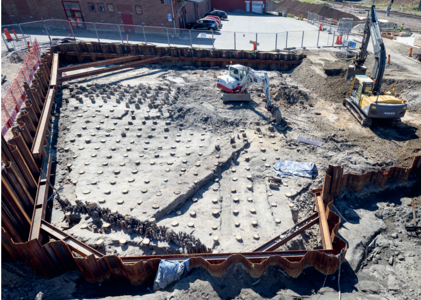
Figur 13. Pålarna under betongplattan, flera av dem har kapats för att underlätta undersökningen. Närmast kameran syns även pålraden utmed vallen. Foto från norr Markus Anderson.
